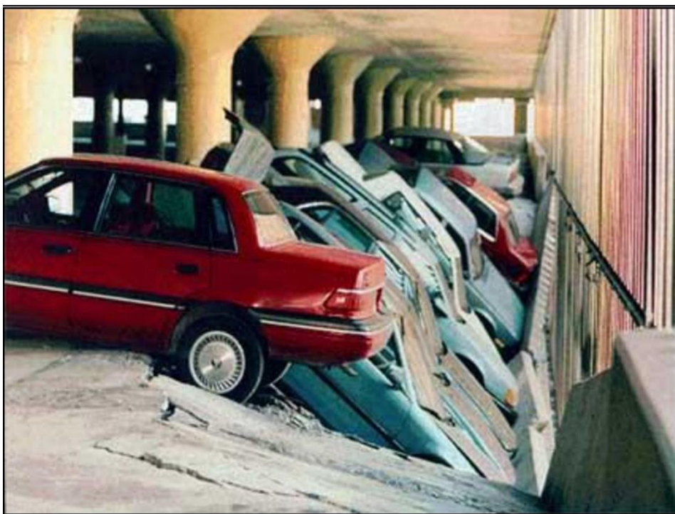
خرابی پارکینگ گاراژ در اثر اشتباه در طراحی و اجرا
