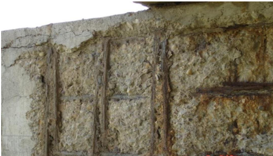
(شکل ۱-۱) طبله شدن بتن و خوردگی شدید میلگردها در اثر توامان نفوذ کلرید و کربناتسیون
