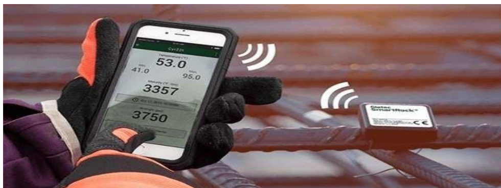
شکل ۲-۱۲ تعیین میزان مقاومت نهایی یا بلوغ بتن، با استفاده از حسگر بلوغ بتن
